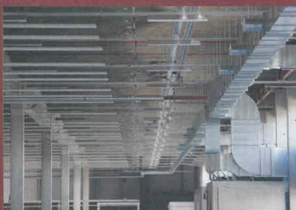
Om heel gerichte verwarming en koeling te geven is in het distributiecentrum gekozen voor stralingspanelen.
