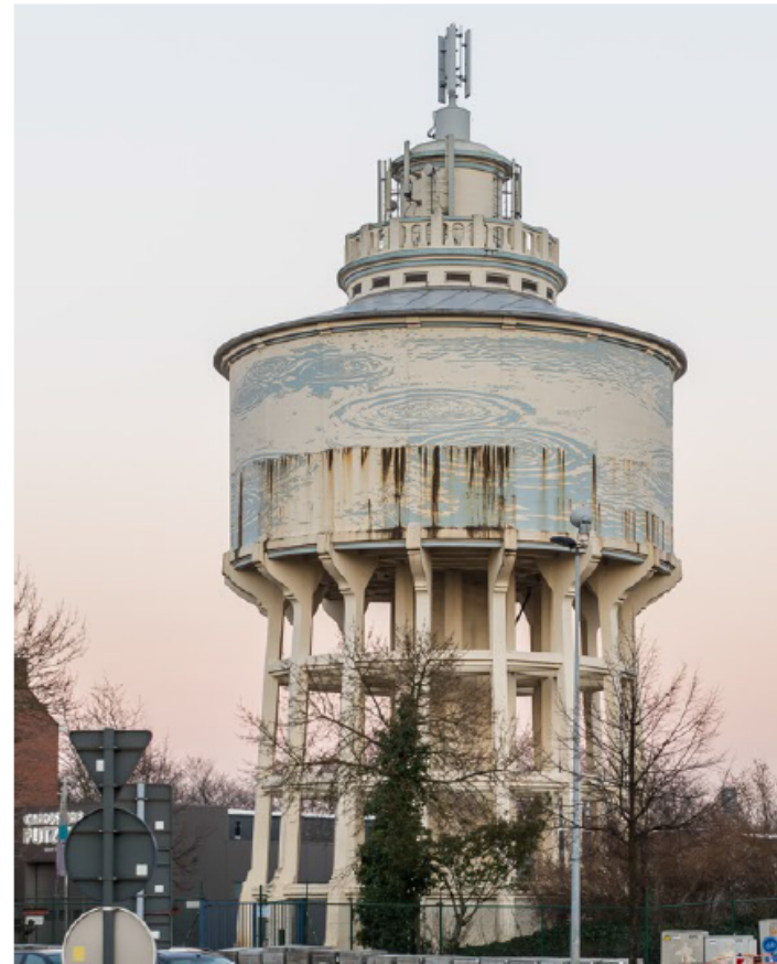
Of De Watertoren, een iconisch zicht in Hasselt, een nieuwe bestemming krijgt of wordt afgebroken, is nog niet duidelijk. © mist
