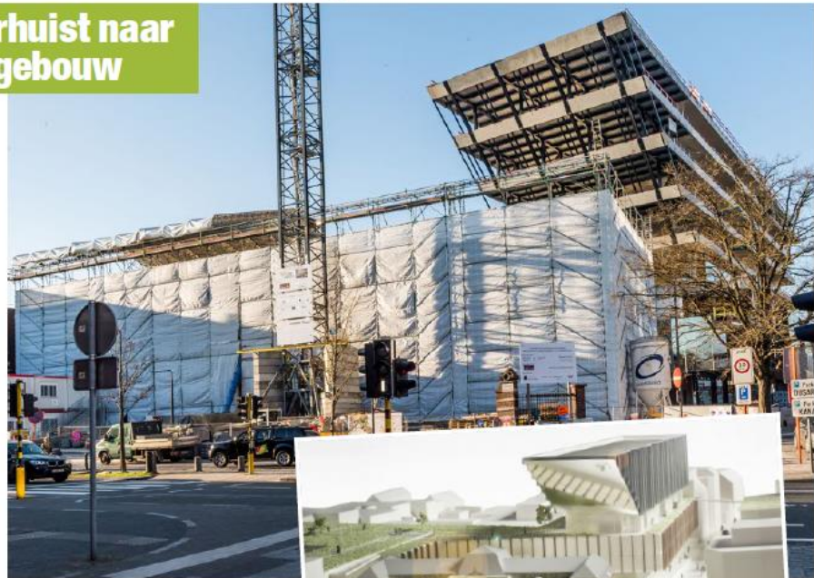
De kazerne staat momenteel in de steigers voor renovatie. Radio 2 komt in de rechtervleugel. FOTO MIST/HBVL
